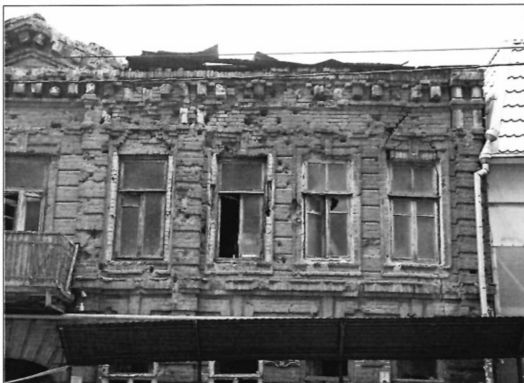
5. Следы от обстрелов в годы Великой Отечественной войны в восточной части главного фасада в уровне второго этажа. Фото 2023 г.
